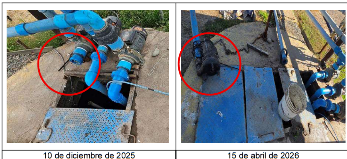
Imagen N°10: Bombas elevadoras de la PTAS Gacitúa.
