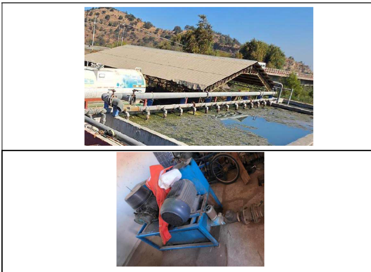
Imagen N°14: Sistema de aireación en piscina de lodos y compresor sin funcionar.
