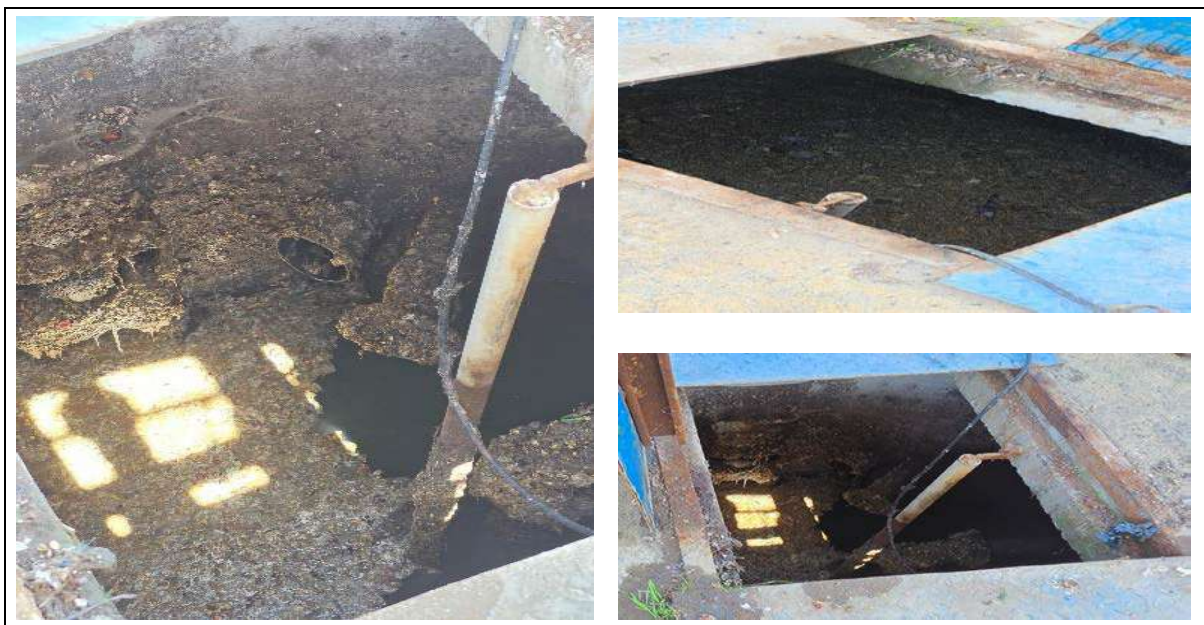
Imagen N°8: Cámara de bombas con sólidos suspendidos.
