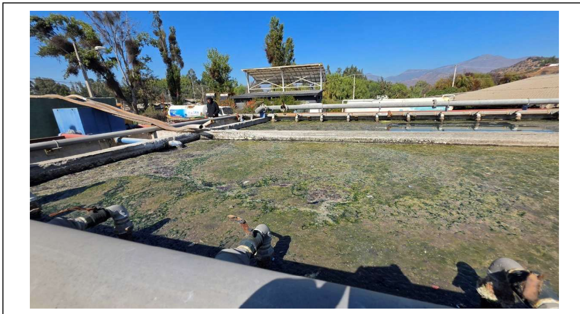
Imagen N° 12: Piscina de tratamiento de lodos sin aireación, con sólidos suspendidos y lodos acumulados.
