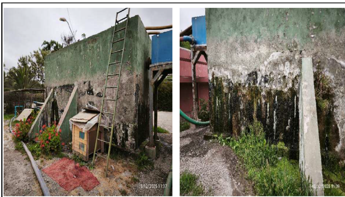
Imagen N°13: Infraestructura de desarenador con humedad.
