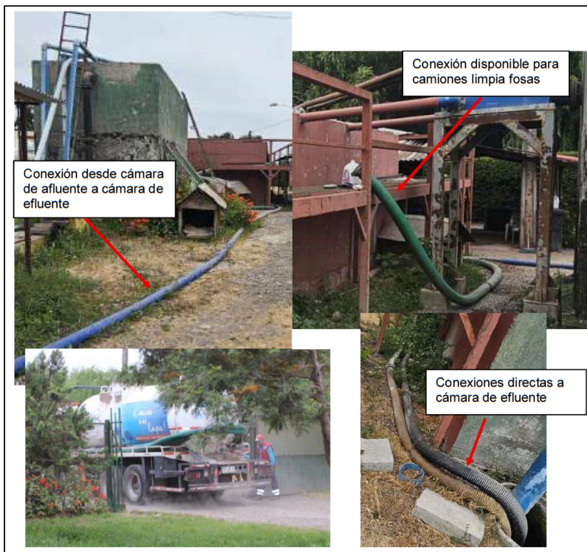
Imagen N° 3: Conexiones irregulares en cámara de efluente.
