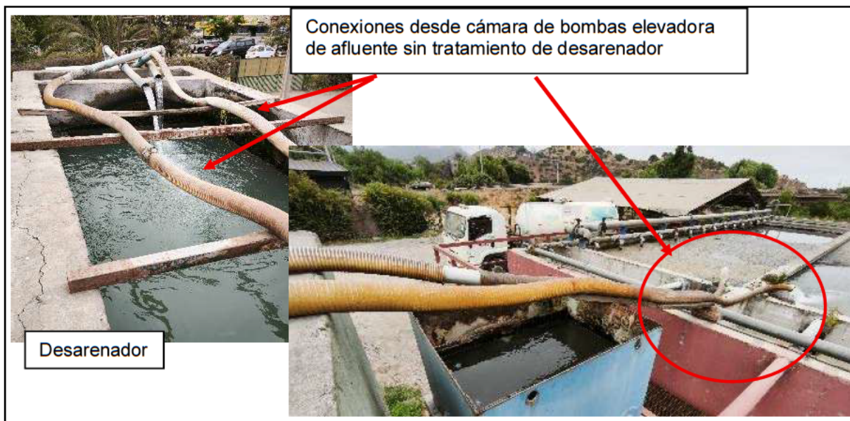
Imagen N° 4: Conexiones irregulares, descarga de agua cruda a piscina de lodos sin tratamiento de desarenador.
