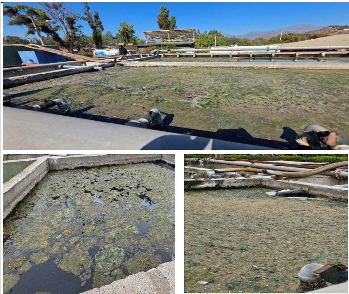
Imagen N° 6: Piscina de tratamiento de lodos con sólidos suspendidos y lodos acumulados.
